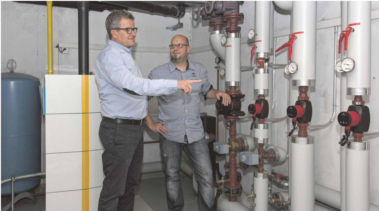
Kurt Isenschmid (links) mit Tobias Schuler, Chef der Heizungsabteilung in der Heizzentrale der neuen Heiz- und Klimaanlage.
